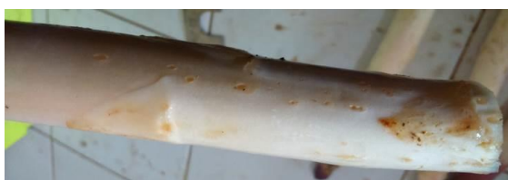
Dégâts de myriapodes - Photo SUDEXPE
